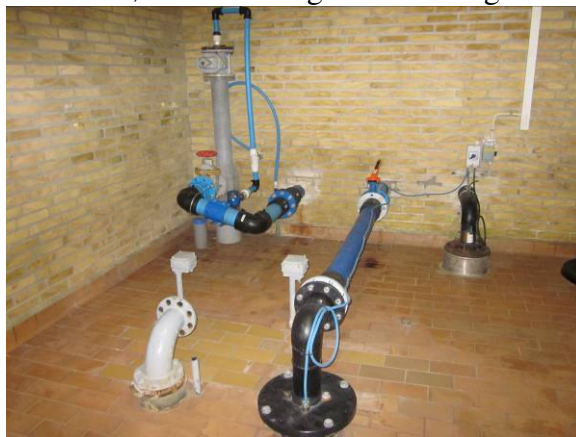
Sindrigt rørsystem, for overførselspumper som også kan anvendes til udpumpning
