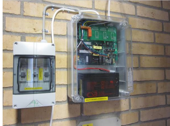
Styring og nødstrøm til lukning af ventil til hydrofor i tilfælde af strømsvigt.
