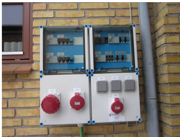
Tavle for udtag fra nødgenerator
