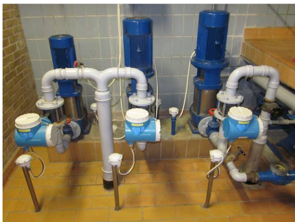
Udpumpningsanlæg i sektion 2
