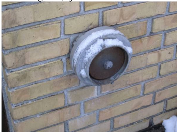
Brandsugestuds til tank i sektion 1
