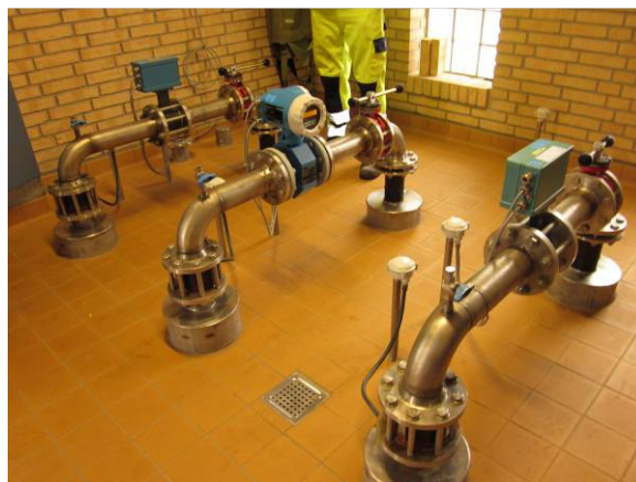
Udpumpningsanlæg i sektion 4
