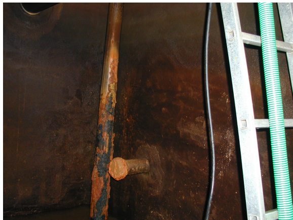
Sugerør indvendigt i tank tæret. Foto David Ipsen
