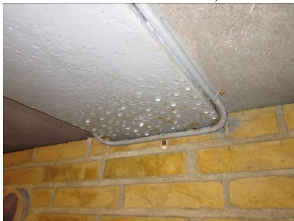
Kondens på stålbjælke i tagkonstruktion
