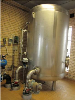
Hydrofortank i sektion 4
