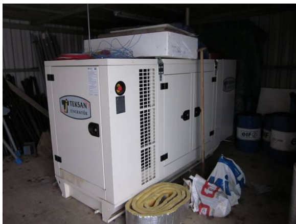
Nødgenerator placeret i garage
