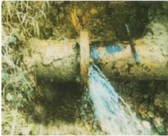
Vandværkerne i Slangerup Kommune har godt styr på vandtab fra lækager i vandledningerne.
